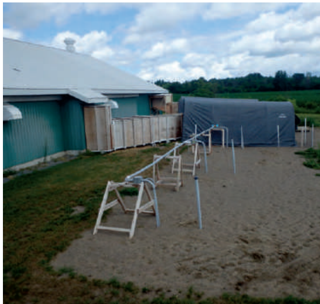
Puits de captation du système d'aérogéothermie.
